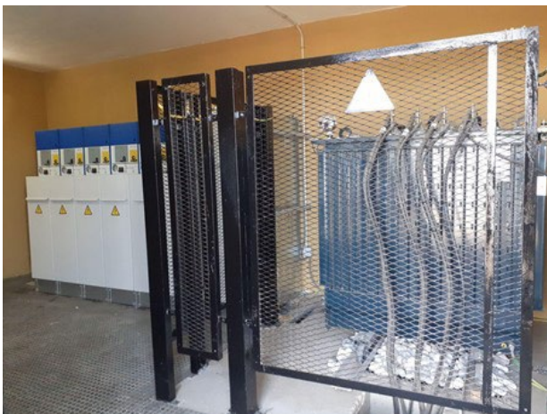
Interior reformado del Centro de Transformación CT-1 del Observatorio del Teide (IAC).
