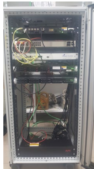
Armario de redes, sincronización y control de alto nivel.
