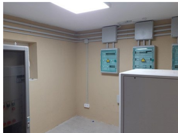
Nuevo Cuarto Técnico del Telescopio Carlos Sánchez (IAC).
