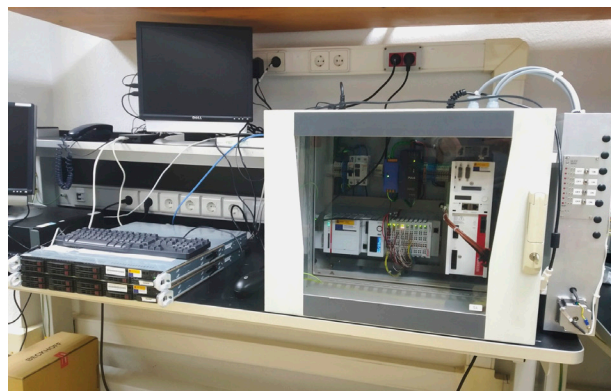
Armario de pruebas (derecha) y servidores (izquierda) en el Laboratorio de Electrónica.
