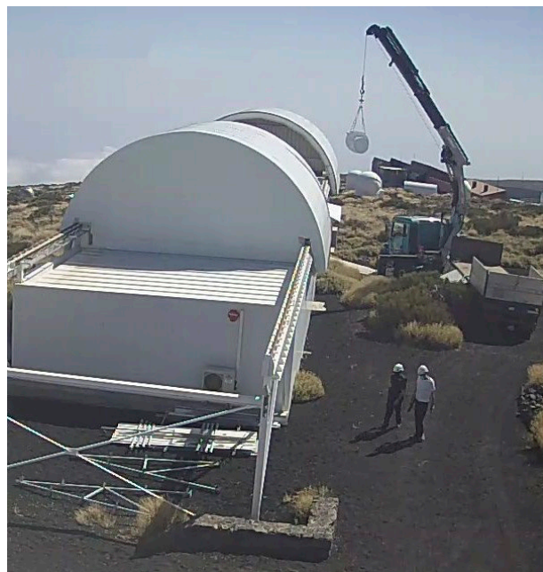
Instalación del Instrumento FTGI en el QT2.
