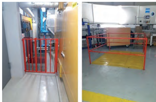
Barreras y barandillas de seguridad instaladas para poder manipular las grúas de la OGS de acuerdo a la Ley de Prevención de Riesgos Laborales.
