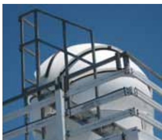
Detalle de la barandilla de seguridad instalada en el DIMMA del Observatorio del Teide, al objeto de mejorar la seguridad de las personas durante el acceso a la cúpula, pero desmontable durante las observaciones rutinarias.
