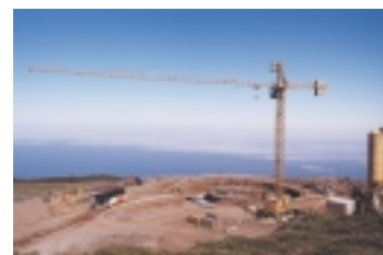
Explanada en obras donde será instalado el GTC y donde tuvo lugar el Acto de Colocación de la Primera Piedra del edificio de este telescopio.
